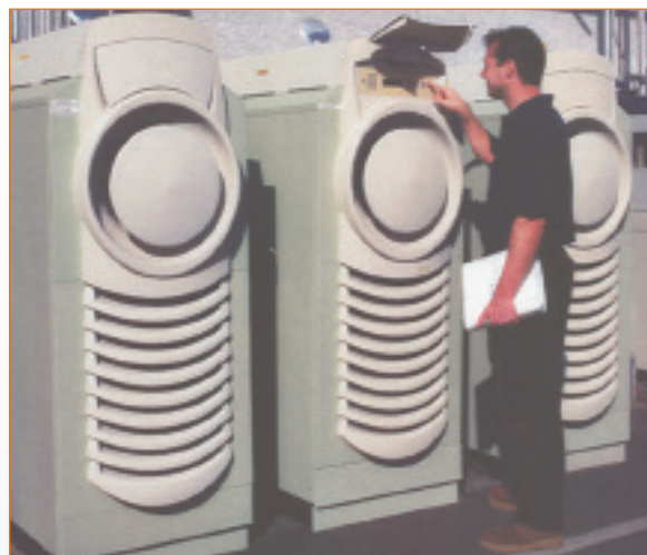
Tres microturbinas de 30 kilovatios que operan con gas de vertederos en California (Estados Unidos).
