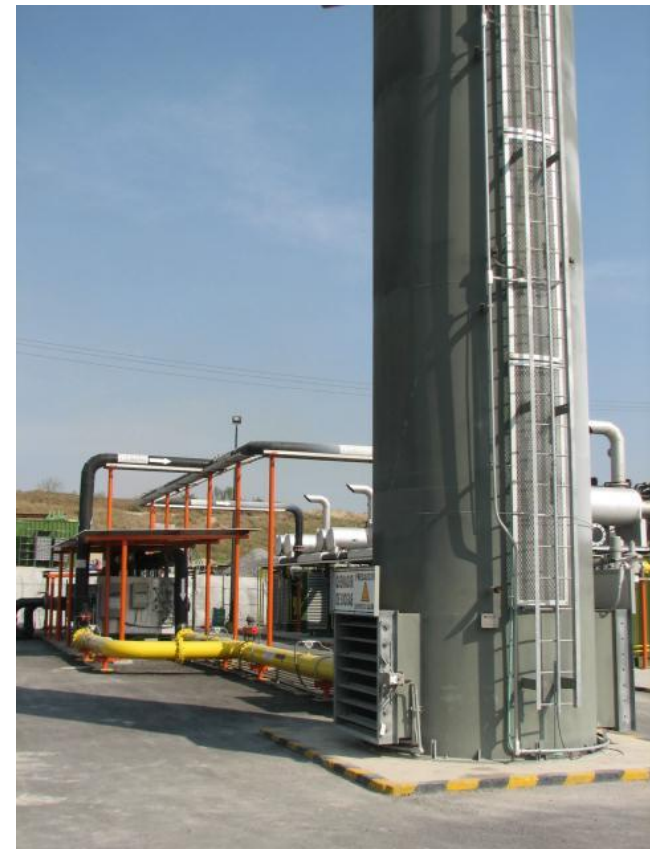
Monterrey – Moto generador en contenedor y estación de succión y quemado
