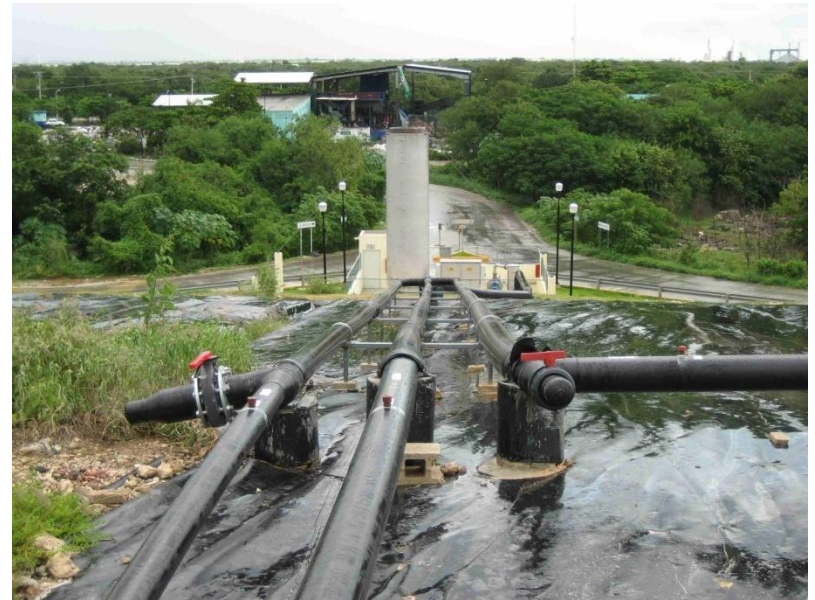
Mérida – Tubería principal al quemador
