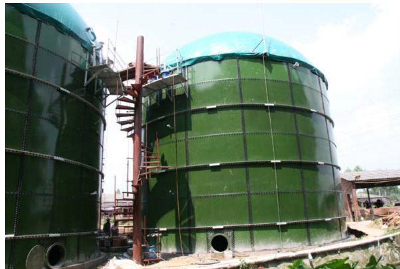
益湖猪场采用搪瓷钢一体化储气罐
