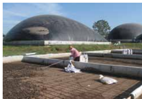
Digestor anaeróbico con pozos secos de sólidos en primer plano (Tailandia)
